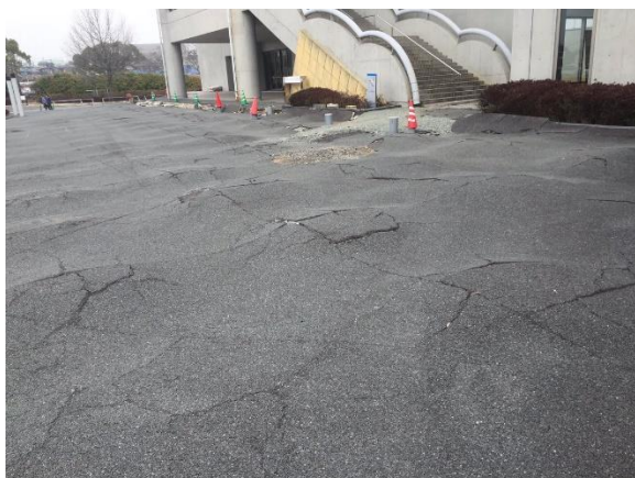
(益城町総合体育館のアスファルトの様子)
